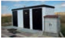
MANTENIMIENTO DE CENTROS DE TRANSFORMACIÓN (C.T.)
